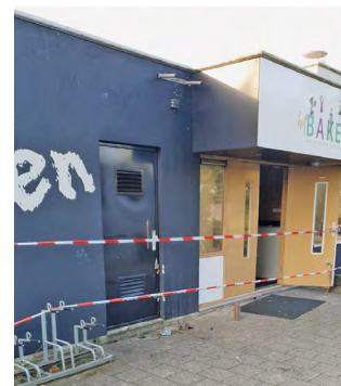
De afgezette hoofdingang met links de deur naar de technische ruimte waar de brand is ontstaan.
